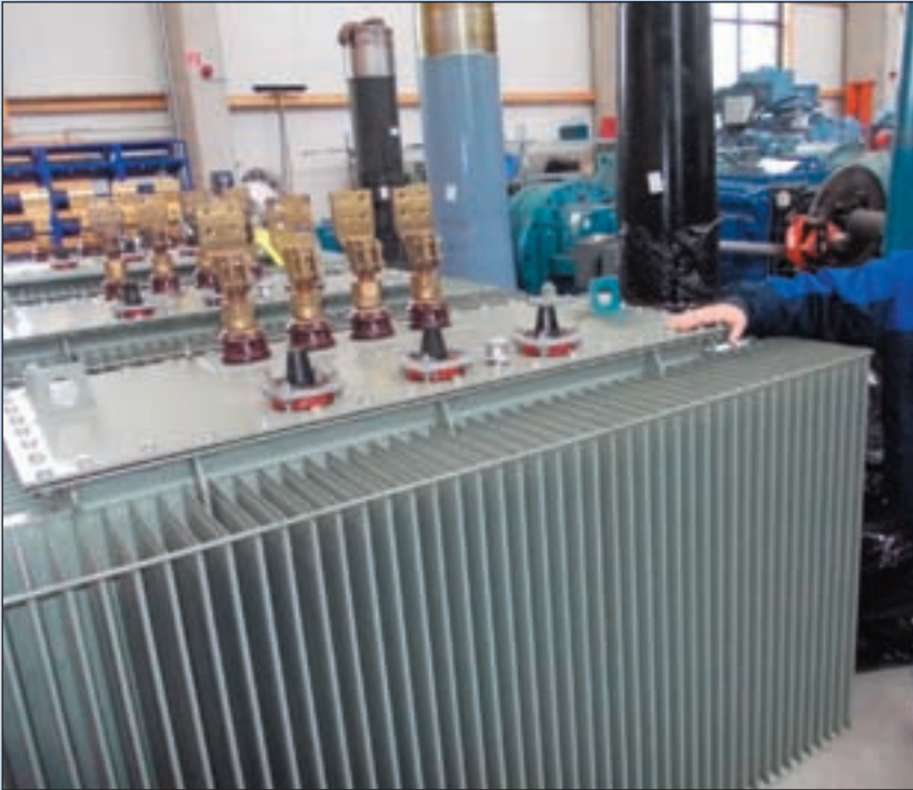
Transformatoren mit 690 Volt Primärspannung und 20.000 Volt Sekundärspannung
